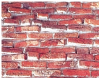
appareillage inacceptable avec moins-value
